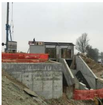
Formigliana (VC) — centrale idroelettrica
